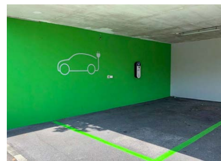
Tanken heisst nun laden: Die öffentliche Ladestation für Elektroautos an der Grisiengenstrasse 1 in Horw.
